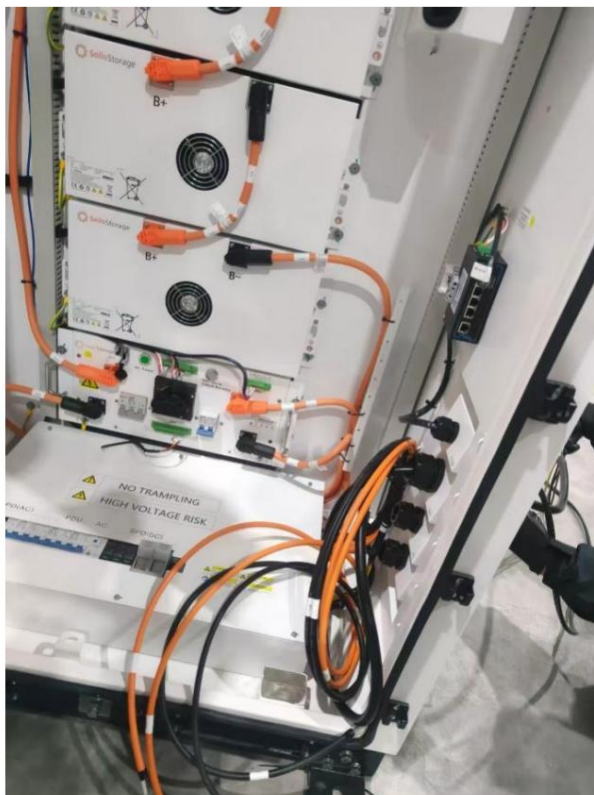
Figure 6-1 Câbles préinstallés à l'intérieur de l'armoire
